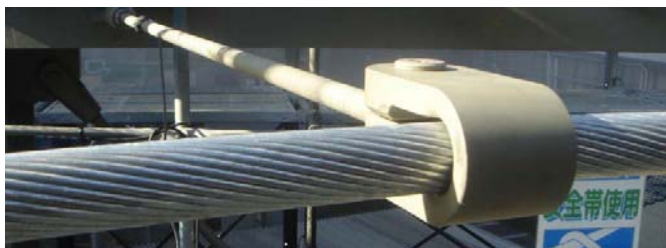
リングケーブルとステイロッド接合部
